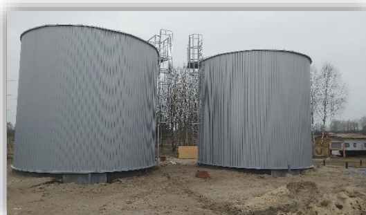
Fot. Stacja uzdatniania wody w msc. Gnaty
